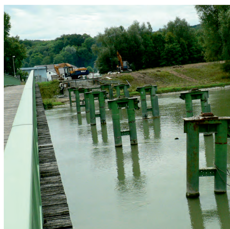
Abbruch der alten Brücke. Die Fußgängerbrücke links bleibt während der Bauarbeiten als Behelfsbrücke bestehen.
