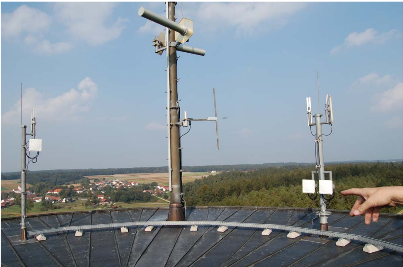
Die Antennenanlage auf dem Wasserturm in Neukreith
