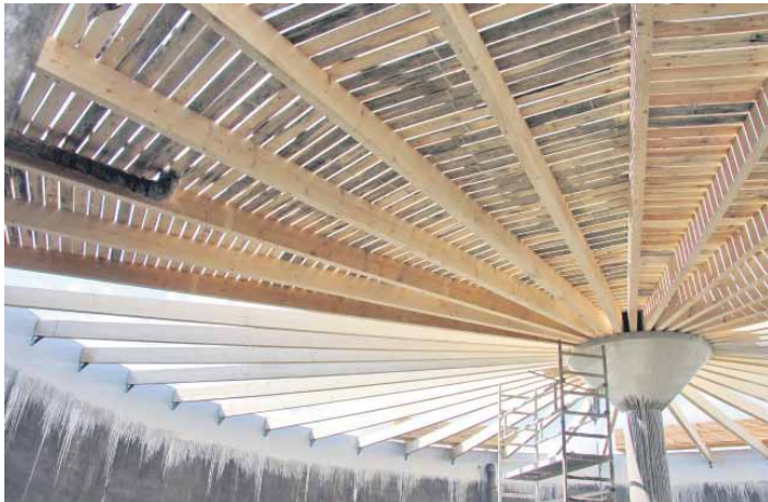
In den meisten Fällen besteht die Dachkonstruktion einer Biogasanlage aus Holz. Versicherer raten heute, die Sparren alle drei bis fünf Jahre auswechseln zu lassen.
