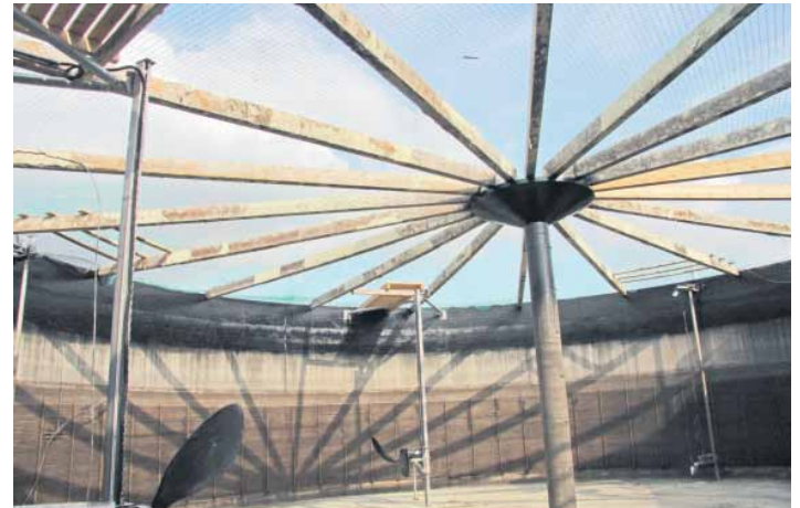
Geöffneter und völlig entleerter Fermenter einer Altanlage, bei der die Holzbalken erneuert werden müssen. Schwefelsäure hat die Holzoberfläche zerstört.
