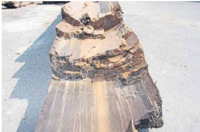
Gebrochene Holzbalken aus der Dachkonstruktion einer Biogasanlage. In der Bruchzone wurde der relativ niedrige pH-Wert 3 ermittelt.
