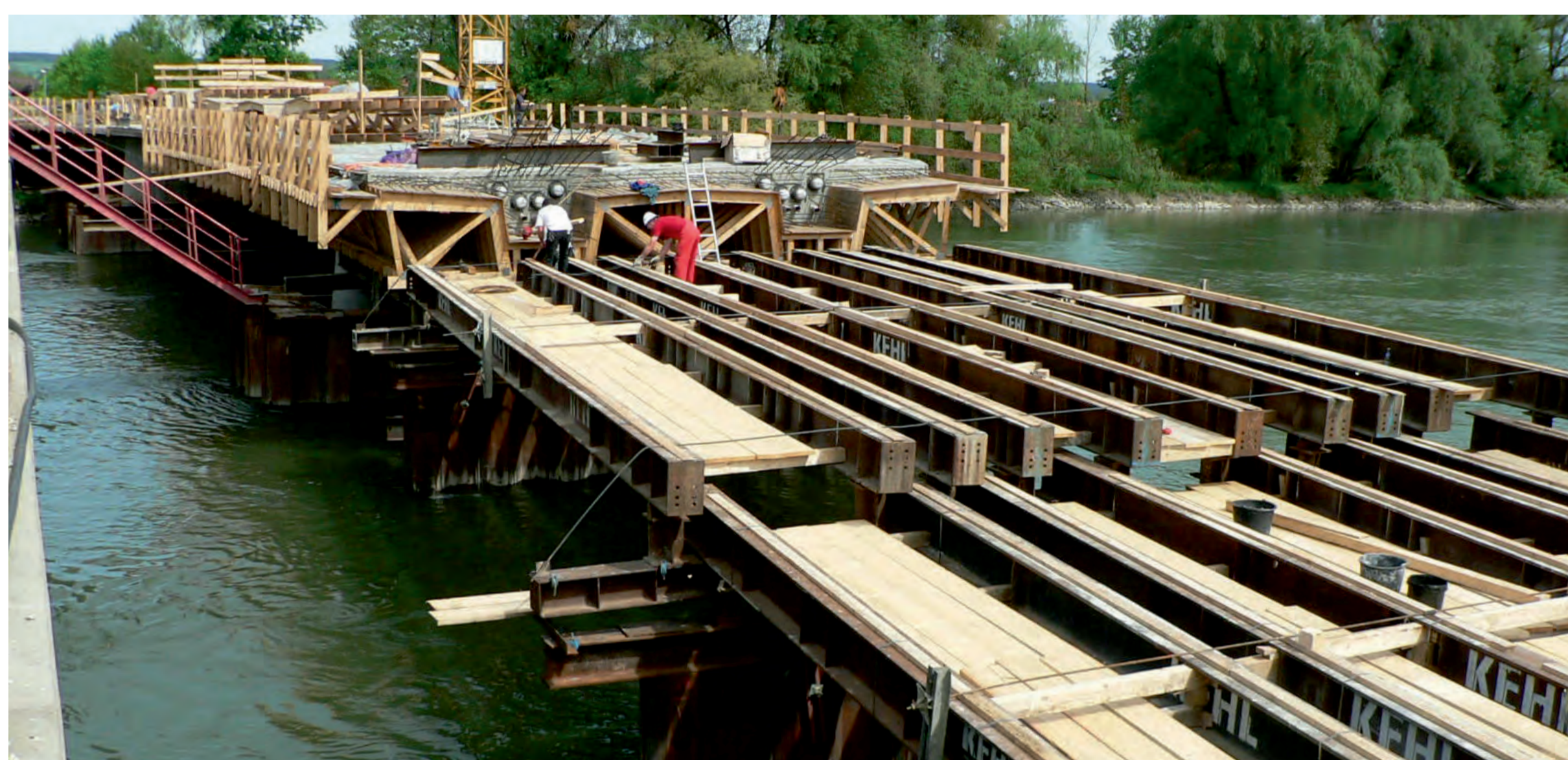
Die neue, breitere Brücke nimmt Gestalt an: Schalung für die neue Brücke. Der Bau war monatelang ein beliebter Rentner-Treffpunkt.
